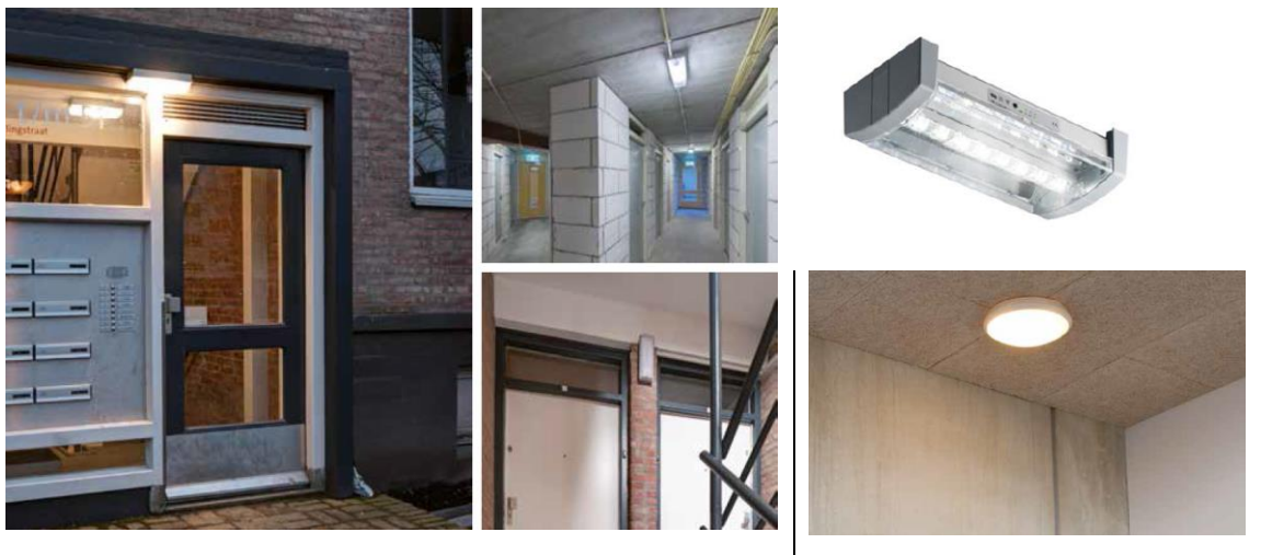
Figuur b11.1: Gebruikte armaturen (links PVX4-armatuur Lightronics, rechtsonder TTN-armatuur Lightronics, rechtsboven noodverlichting van Lien)
