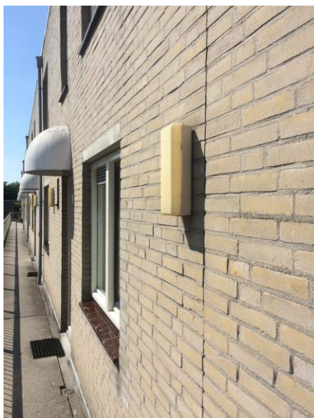
Afbeelding 5.26: Foto van een galerij waarbij de gebruikelijke conventionele verlichtingsarmaturen meer licht naar de hemel uitstralen dan naar de vloer en woning (Woningstichting Samenwerking).
