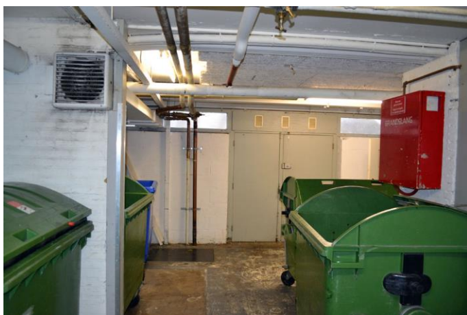
Afbeelding 4.7: Foto van een containerberging waar de verlichting brandt, ondanks het daglicht en de afwezigheid van bewoners (Woonstad Rotterdam).
